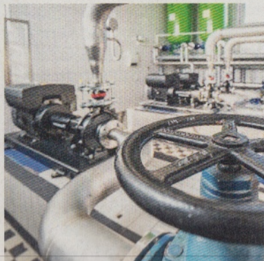
Die Förderung für den Austausch von alten durch hocheffiziente Pumpen beträgt 30 Prozent der Nettoinvestitionskosten. Bild: Pescontracting/Mario Dirks
